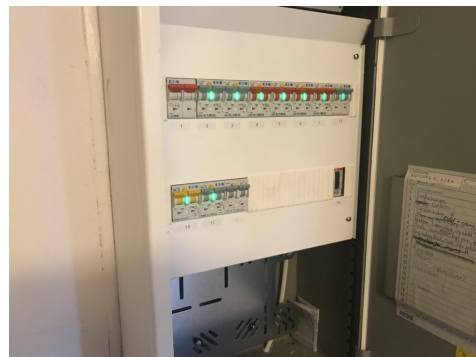
Sikringsskap med egen måler til utleiedel
