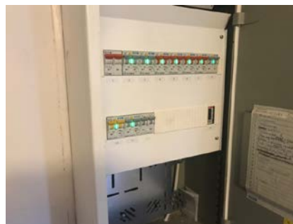
Sikringsskap med egen måler til utleiedel
