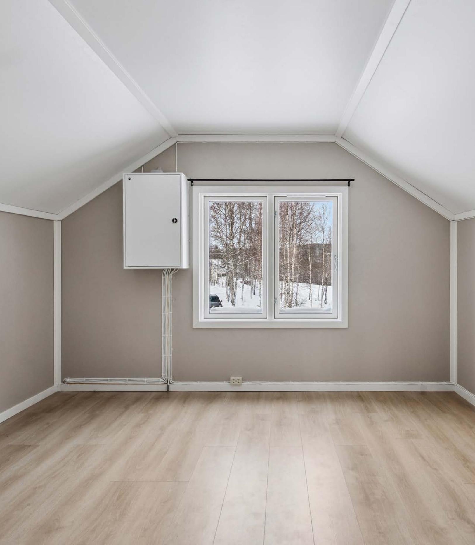
Soverom 3. Her er også sikringsskapet, som ble oppgradert i 2024.
