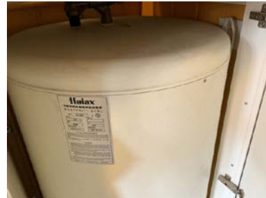
Lite drypp merker på toppen av tanken.
