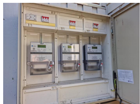
utvendig strømkasse med målere og stigersikringer
