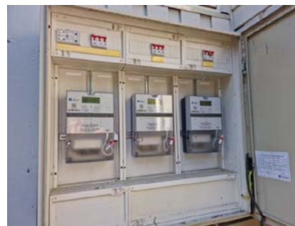
utvendig strømkasse med målere og stigersikringer
