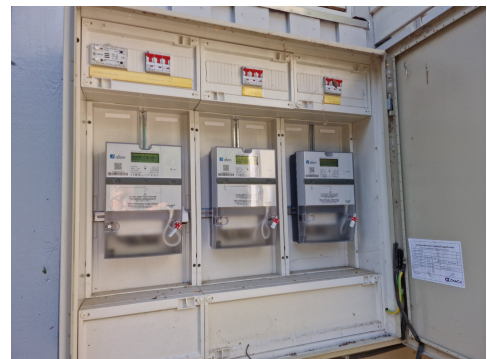
utvendig strømkasse med målere og stigersikringer
