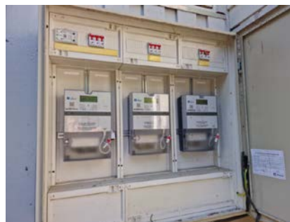
utvendig strømkasse med målere og stigersikringer
