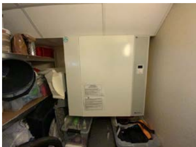
Balansert ventilasjon. Aggregat er montert i innvendig bod.
