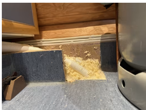
Det er ikke oppbrett på gulv ved døråpning eller ved baderomsinnredningen.
