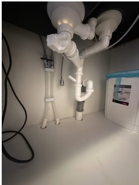
Viser vann og avløpsinnstallasjoner under kum.
