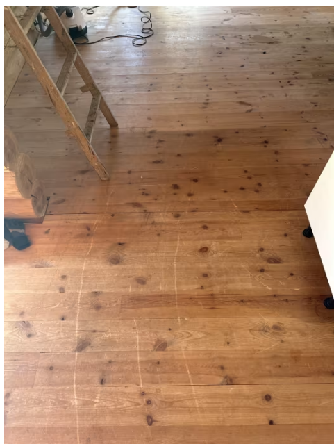
Det registreres en god del slitasje på tregulv.
