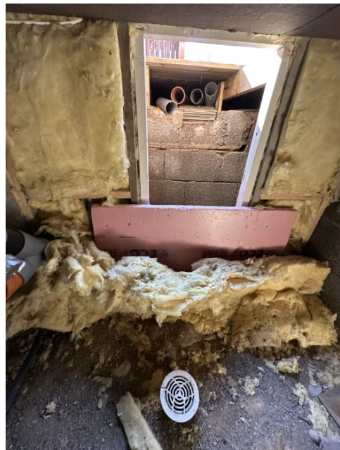
Åpen veggkonstruksjon, isolasjon fritt eksponert.
