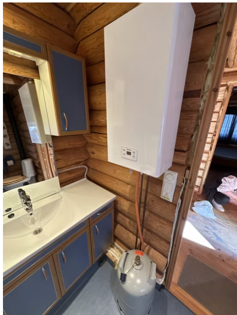
Viser bereder plassert på badet.
