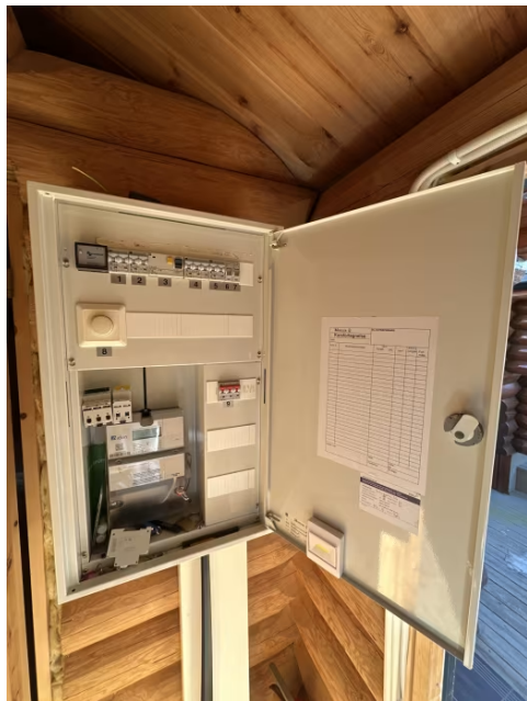
Viser sikringsskap plassert i gang.
