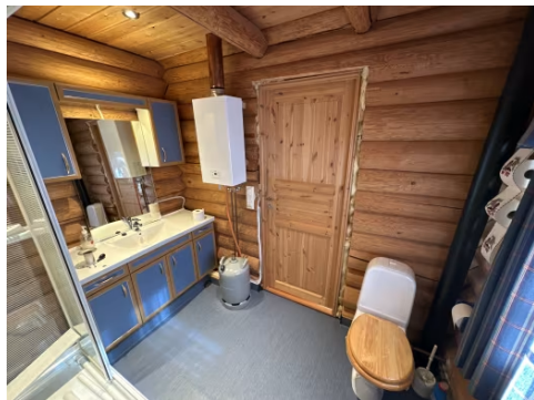
Viser baderomsinnredning, bereder og gulvstående toalett
