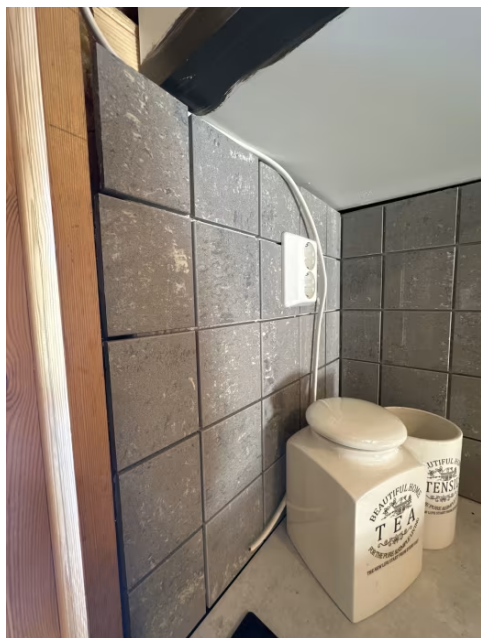
Kable på kjøkkenet er ikke avsluttet forskriftsmessig.
