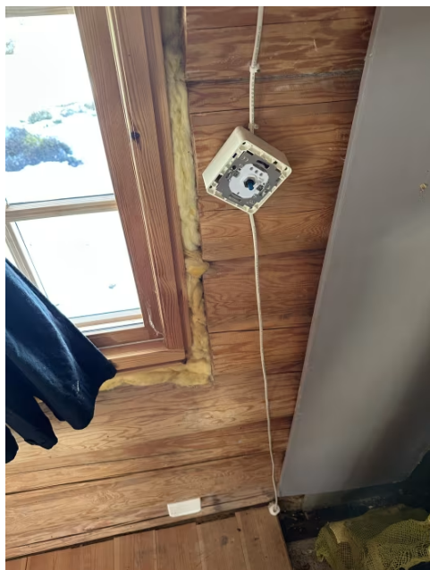
Det registreres dårlig innfesting på elektrisk utstyr. Dimmer mangler lokk.
