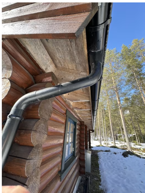
Det gjenstår arbeid ved takkonstruksjonen.
