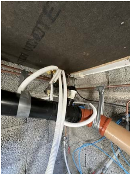
Det registreres ufagmessig utførelse av avløpsledninger.
