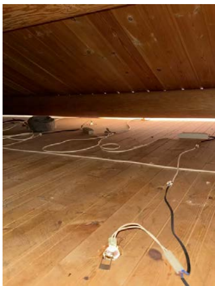
Kabler til spotter er ikke avsluttet fagmessig på hems. Det mangler spotkasser på halogenspotter. Fremstår ufagmessig utført.
