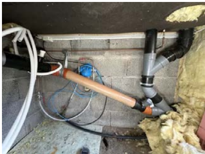
Viser vann og avløpsinnstallasjoner i rom under terreng.
