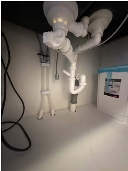
Viser vann og avløpsinnstallasjoner under kum.
