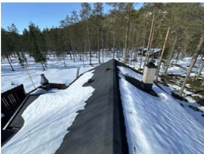
Viser takteking. Deler av taket var snødekt og er ikke kontrollert.
