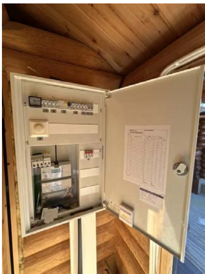
Viser sikringsskap plassert i gang.
