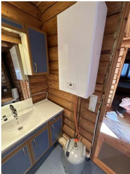
Viser bereder plassert på badet.
