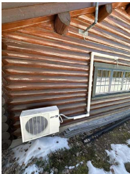
Viser utedel luft - luft varmepumpe.
