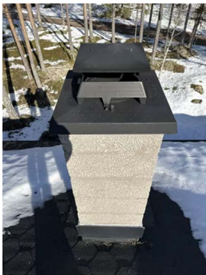
Viser pipe over tak.
