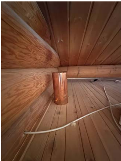
Avgassrør til bereder er ikke avsluttet over tak. Fare for liv og helse.
