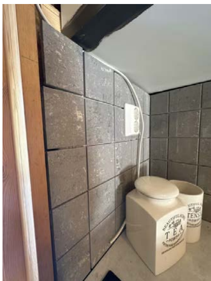
Kable på kjøkkenet er ikke avsluttet forskriftsmessig.
