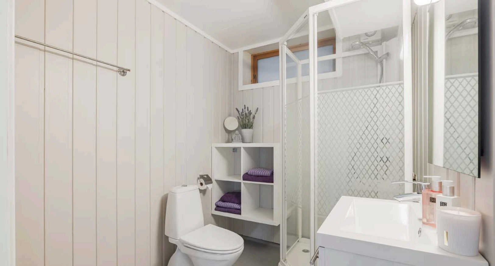
Eldre badrom i kjelleretasjen som må oppgraderes for å tåle normal bruk etter dagens krav. Badrommet har våtromsbelegg på gulv med varmekabler, overflater med malt panel og dusjkabinett hindrer direkte vannsprut.
