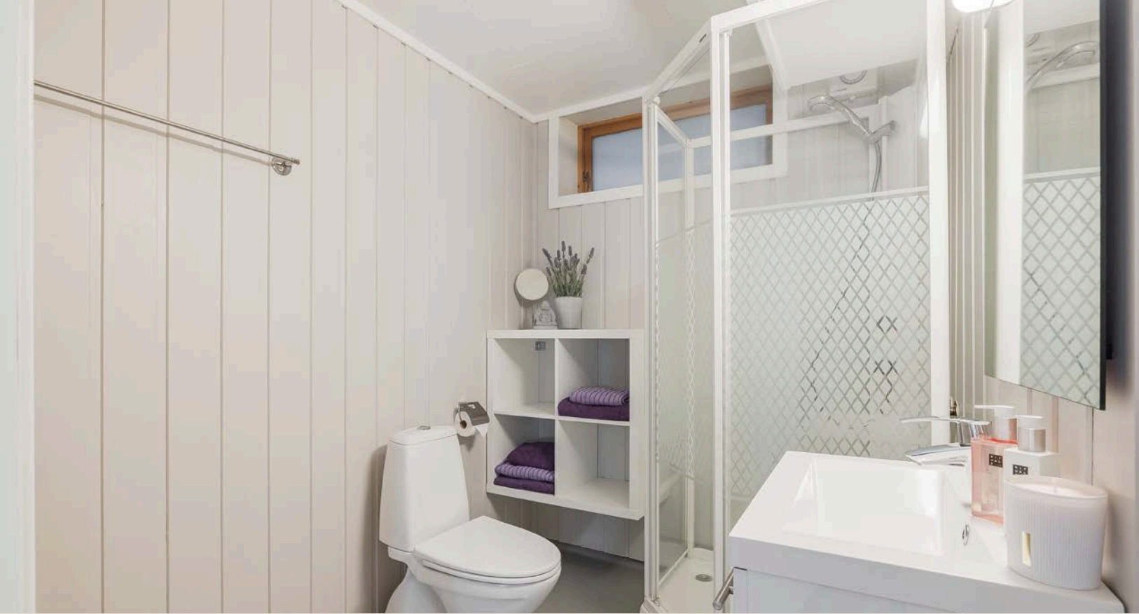
Eldre baderom i kjelleretasjen som må oppgraderes for å tåle normal bruk etter dagens krav. Baderommet har våtromsbelegg på gulv med varmekabler, overflater med malt panel og dusjkabinett hindrer direkte vannsprut.
