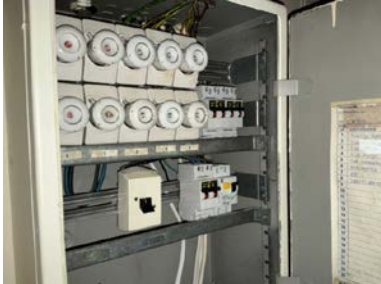
Kombinasjon av automat- og skrusikringer i felles sikringsskap plassert i hall.
