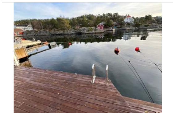
Brygge, oppgradering må påregnes.
