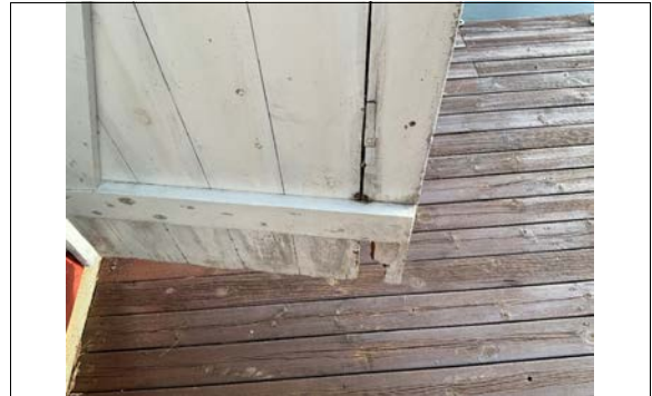
Råte i døren.
