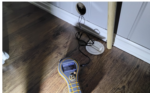
Fuktsøk i vegg mot badet.
