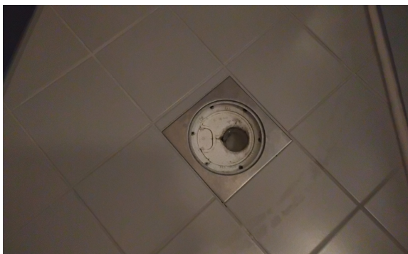
Sluk på gulvet
