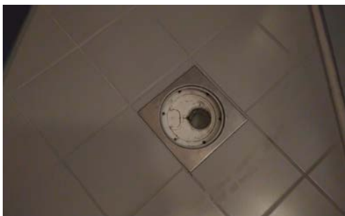
Sluk på gulvet
