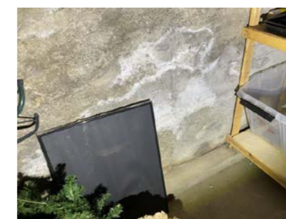
Saltutslag på vegg under terreng.
