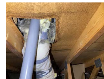
Manglende undertetting på rørgjennomføringer i tak.
