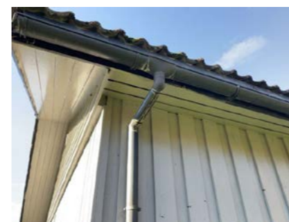
Lekkasje i takrenne.
