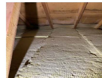
Noe misfarging på undertak ned mot yttervegg,
