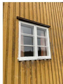
Påbegynnende fukt/råteskader i treverk.
