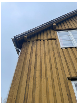
Skader i kledningsbord etter hakkespett
