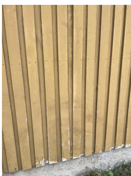
Værslitt overflate og oppsprukket trekledning.
