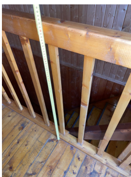
Lavt rekkverk. under 90 cm. jmf. dagens regelverk.
