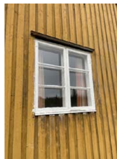
Påbegynnende fukt/råteskader i treverk.
