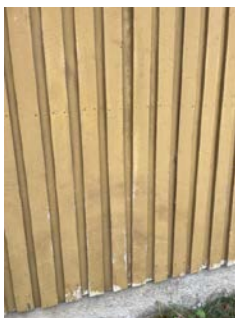
Værslitt overflate og oppsprukket trekledning.
