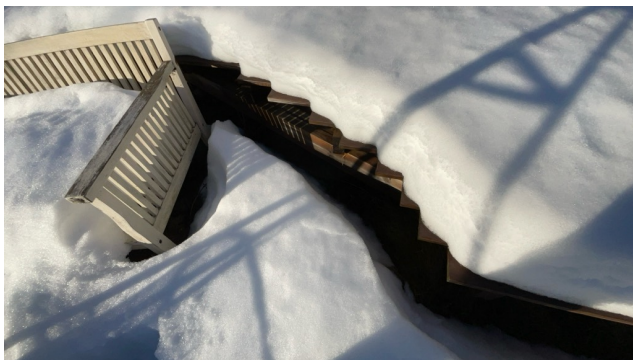
Manglende finisharbeid ytterkant (ikke rekkeverk)
