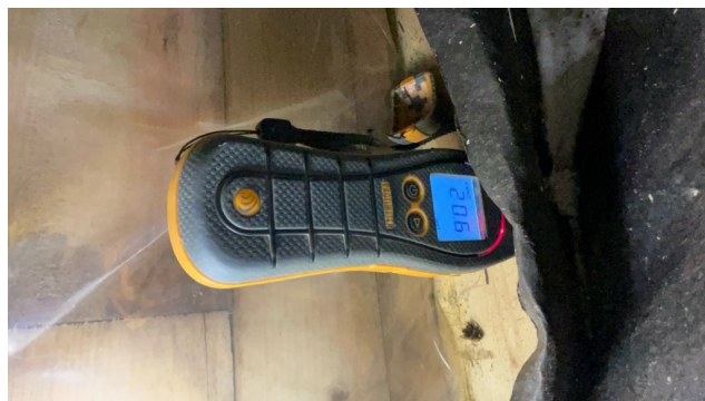
Fuktmåling tilstøtende vegg "gråkjeller"- 20 vekt%
