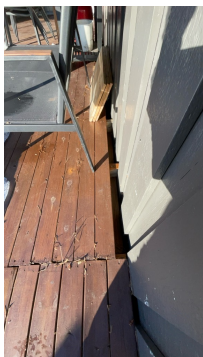
Manglende bord langs vegg, ikke spredt skjøter terrassebord
