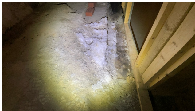
Saltutslag i råkjeller ved siden av vaskerom
