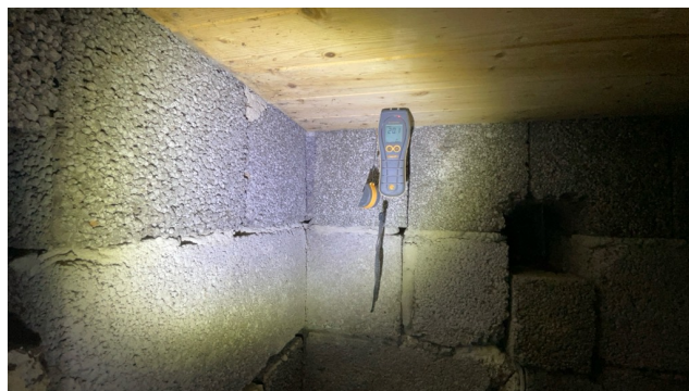
Et hjørne av stubbloftshimling kryperom målt høy fuktverdi- 20 vekt%
