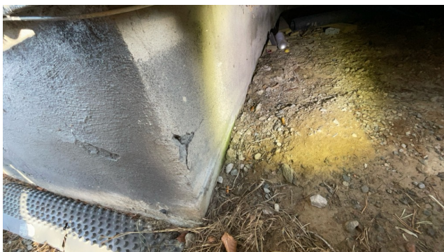
Ikke påvist fuktsperre under hele terrassen
