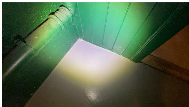
Manglende tettesjikt- trepanel ned mot betonggulvet
