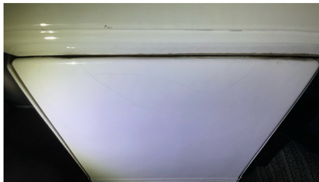
Riss i glassur steinkledning
