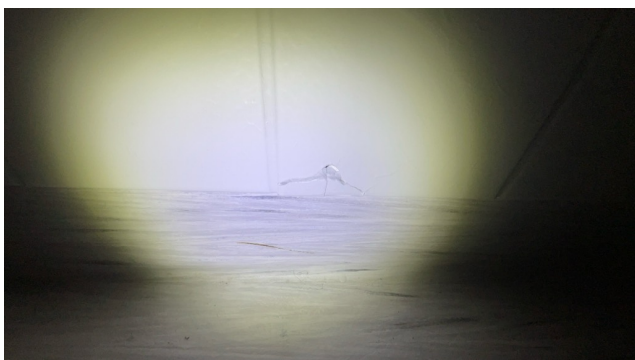
Sprekk i flis
