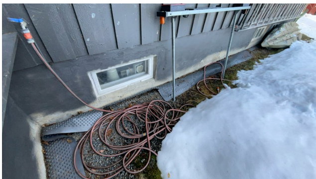
Løs fuktsperre over terreng
