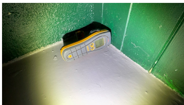
Fuktmåling panelvegg i rommet- 20 vekt%
