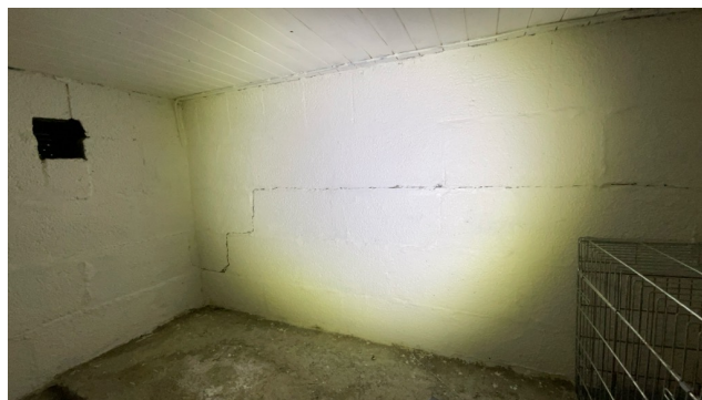
Mindre riss/sprekker i kjeller
