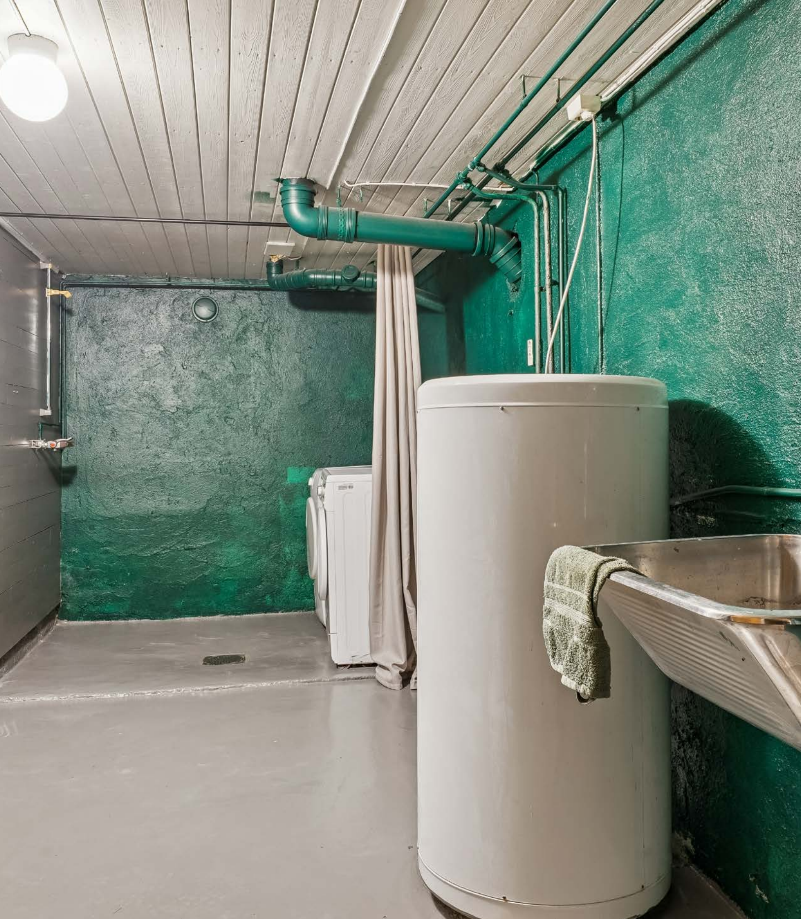
Eldre vaskerom med enkelt opplegg for vaskemaskin og rustfritt vaskekar samt et gammelt dusjbatteri som ikke lenger er i bruk.
