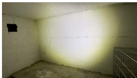
Mindre riss/sprekker i kjeller
