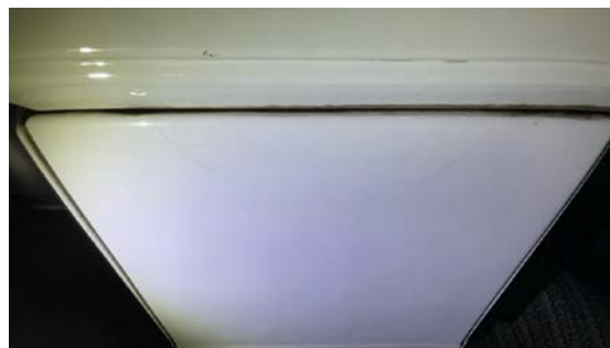
Riss i glassur steinkledning
