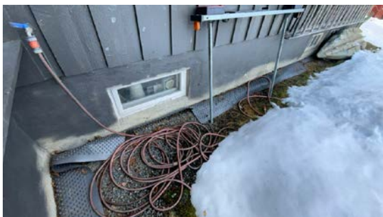
Løs fuktsperre over terreng
