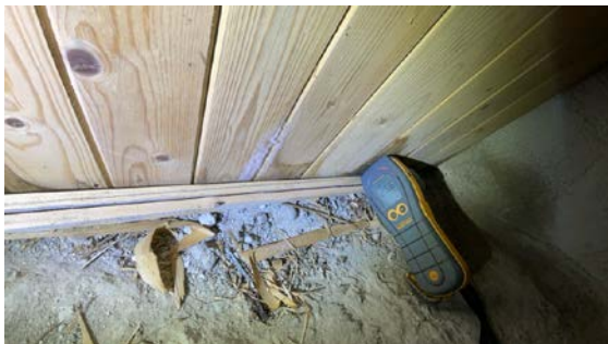
Synlig og målbar fuktbelastning/skjolder mot panel i råkjeller ved siden av vaskerom
