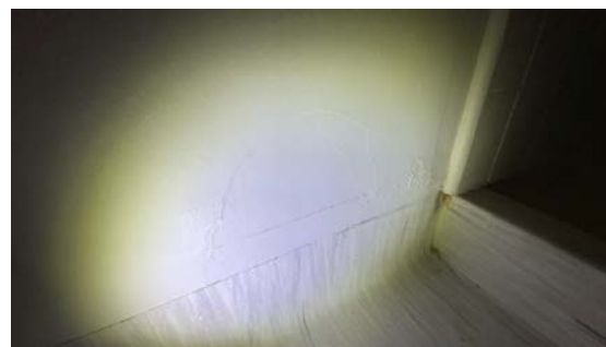
Overmalte rift i tapet ved ytterveg mot våtsone
