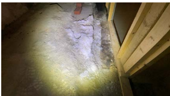
Saltutslag i råkjeller ved siden av vaskerom
