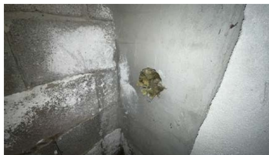
Åpent røykrørshull provisorisk tettet med mineralull
