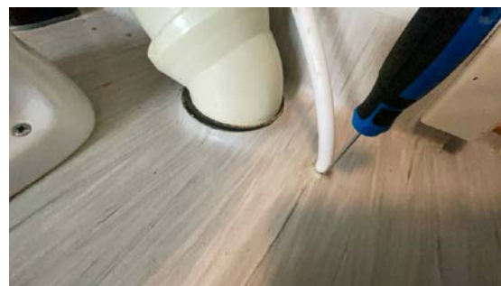
Noe utetthet ved rørgjennomføring toalett
