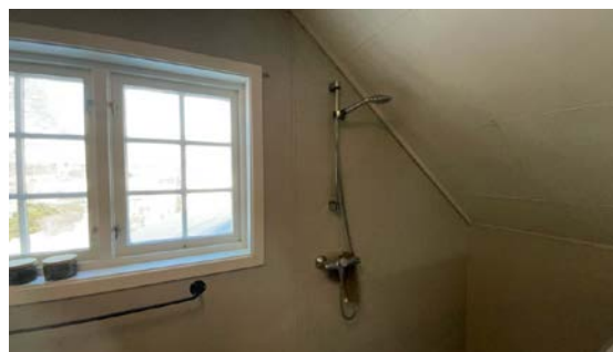
Vindu i våtzone
