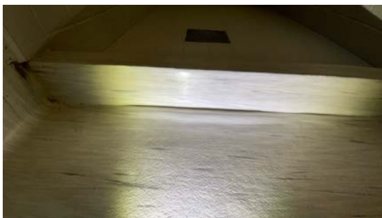
Pløsing i belegget mot dusj.
