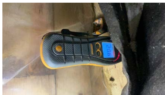
Fuktmåling tillstøtende vegg "gråkjeller"- 20 vekt%
