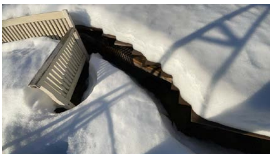
Manglende finisharbeid ytterkant (ikke rekkeverk)
