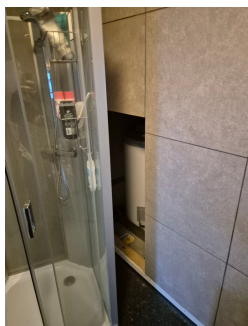
Åpning i vegg bak dusj og trelister i våtsone.
