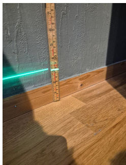
Målt høydeforskjell på soverom 1.
