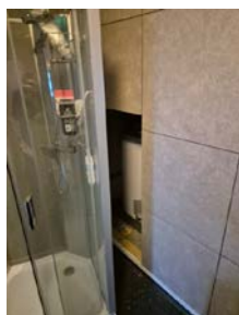
Åpning i vegg bak dusj og trelister i våtsone.
