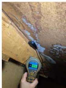
Fuktskjolder, men ikke påvist noe unormalt med fukt.
