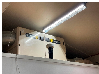
Ventilasjon til cafe
