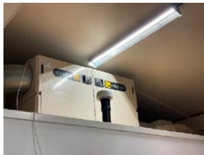
Ventilasjon til cafe
