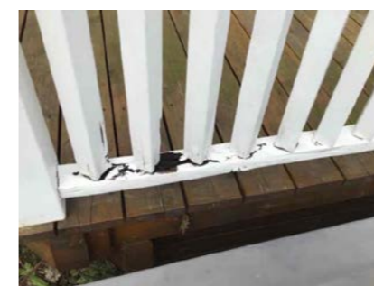
Råte i rekkverk
