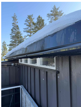
Bildet viser takrenne med deformasjon.
