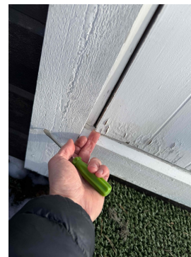
Bildet viser fuktskader i nedkant på dørbladet.
