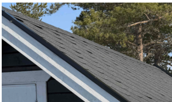
Bildet viser shingellapper som ikke ligger ned mot underlaget.
