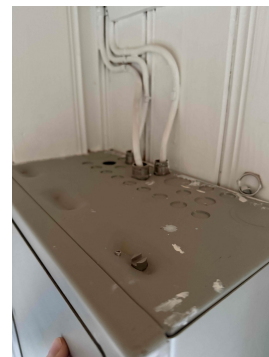
Bildet visert hull i sikringsskap som ikke er tettet.
