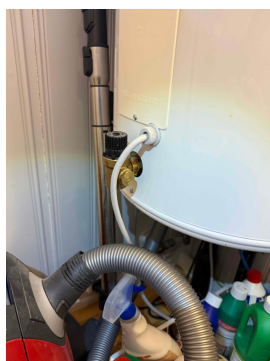
Bildet viser sikkerhetsventil på varmtvannsbereder.
