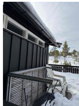
Bildet viser takrenne med deformasjon og lekkasje.
