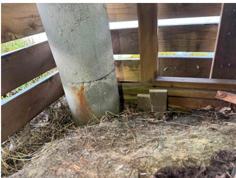
Bildet viser pilar med sprekk.
