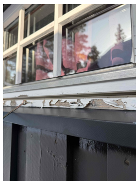
Bildet viser vinduet med avflakking av maling.
