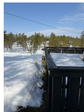
Bildet viser skjevheter i rekkverk.
