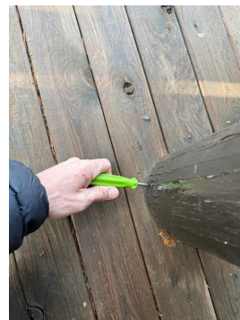
Bildet viser tresøyle med råteskader.
