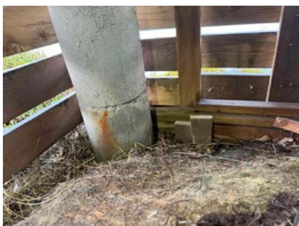
Bildet viser pilar med sprekk.
