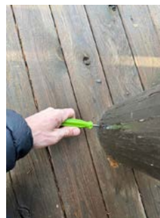
Bildet viser tresøyle med råteskader.
