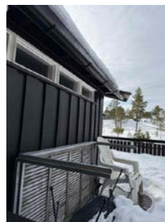
Bildet viser takrenne med deformasjon og lekkasje.
