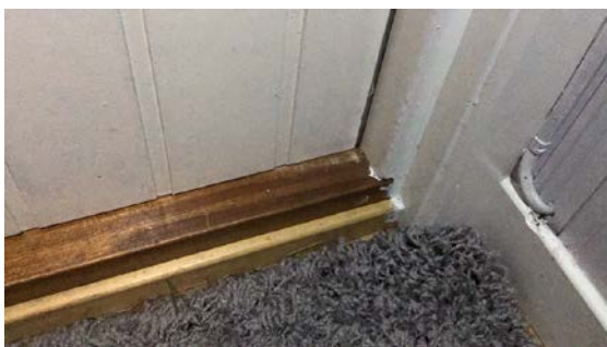
Bildet viser ytterdør som subber i terskelen.
