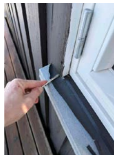
Bilder viser liten klaring til vannbrett og vannbrettbeslag med avslitt behandling/folie.
