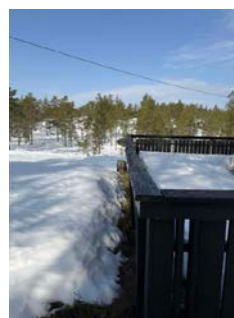
Bildet viser skjevheter i rekkverk.
