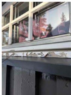
Bildet viser vinduet med avflakking av maling.
