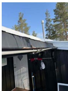
Bildet viser takrennen med lekkasje.
