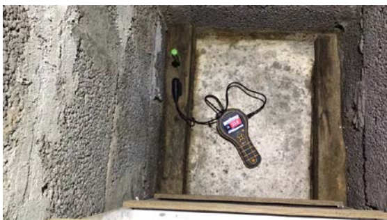
Bildet viser høye fuktverdier og råte i treverk i bunnen av matluken.
