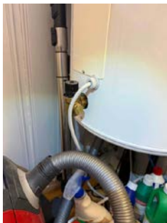
Bildet viser sikkerhetsventil på varmtvannsbereder.
