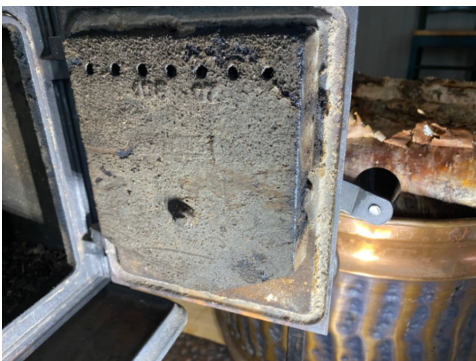
Pakning rundt dør mangler.
