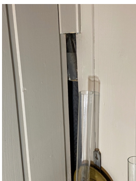
Manglende avslutning hjørne vegg
