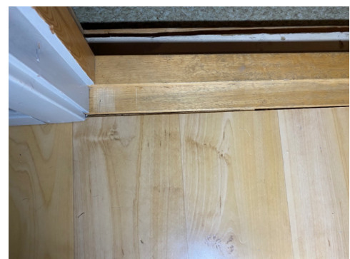
Manglende avslutning mellom terskel/gulv.
