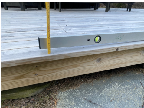
Skjevheter i terrasse.
