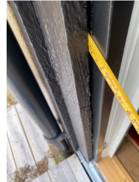
Åpning mellom dekkbord og karm.
