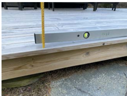
Skjevheter i terrasse.
