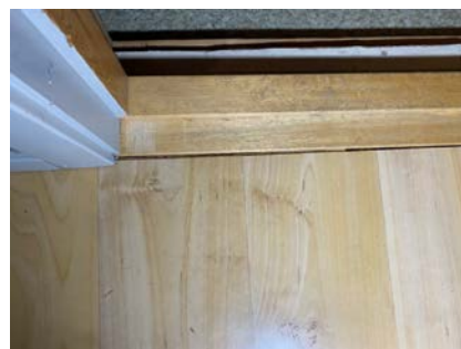
Manglende avslutning mellom terskel/gulv.
