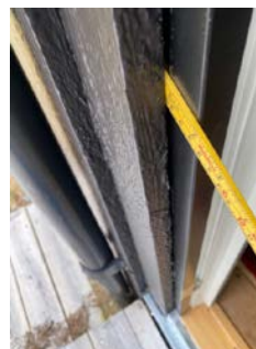
Åpning mellom dekkbord og karm.
