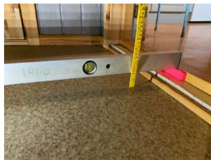
Synlige skjevheter i gulvet på soverom.
