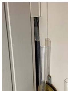
Manglende avslutning hjørne vegg
