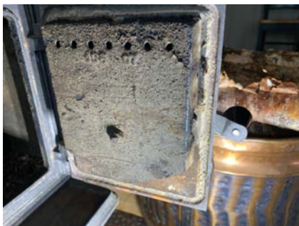
Pakning rundt dør mangler.
