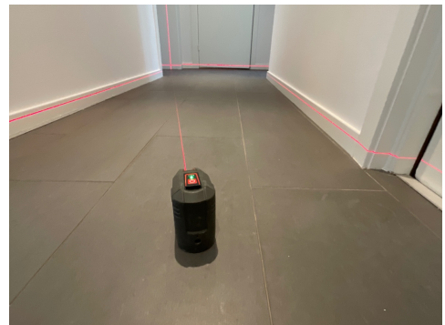
Nivellering entré, avvik ca. 10-20 mm
