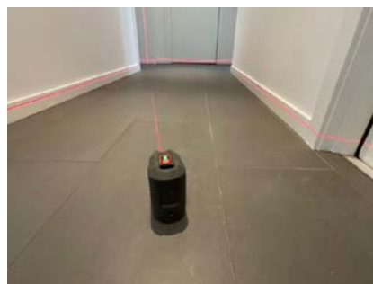
Nivellering entré, avvik ca. 10-20 mm
