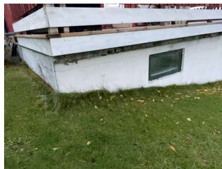
Sprekk under dekke over bod
