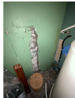
Saltutslag på vegg ved varmtvannsbereder
