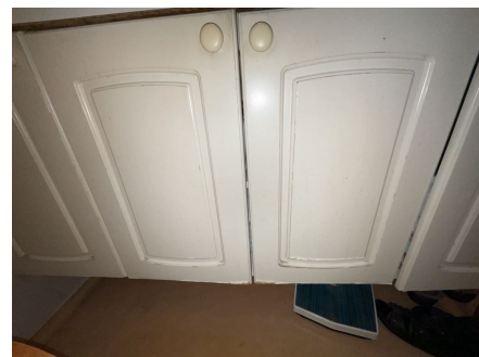
Skade på fronter under vask.
