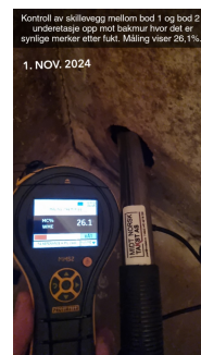
Kontroll av skillevegg mellom bod 1 og bod 2 mot øvre bakmur hvor det er synlige fuktmerker på veggplater og saltutslag på mur. Det er målt 26,1%
