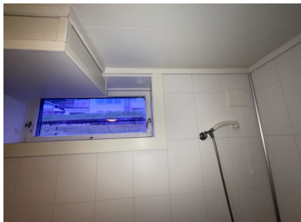
Ventil på vegg og åpningsvindu
