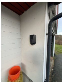
Elbillader er montert utvendig på vegg ved garasje.
