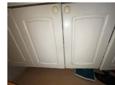
Skade på fronter under vask.
