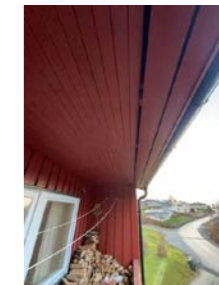
Synlig lufting i raftekasse ved overgang tak/vegg
