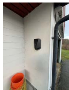
Elbillader er montert utvendig på vegg ved garasje.
