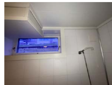
Ventil på vegg og åpningsvindu
