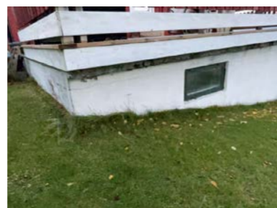
Sprekk under dekke over bod
