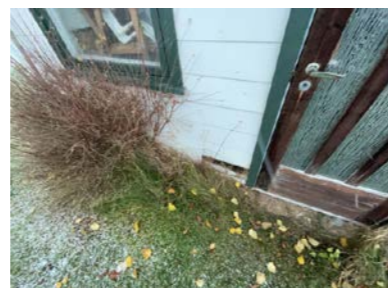
Skade på en eternittplate ved bod under veranda
