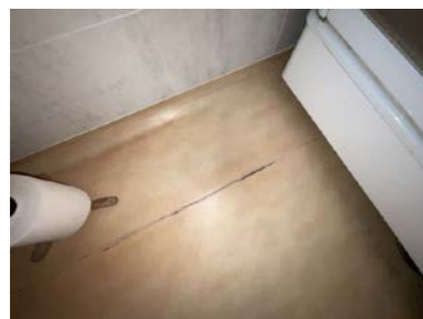
Sprekk i skjøt på belegg mellom dusj og gulvstående toalett.
