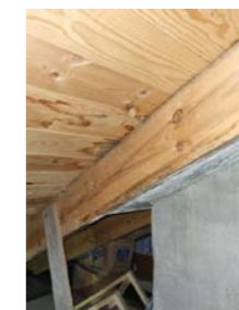
Eldre fuktmerker ved pipe. Ingen fukt på befaringdagen
