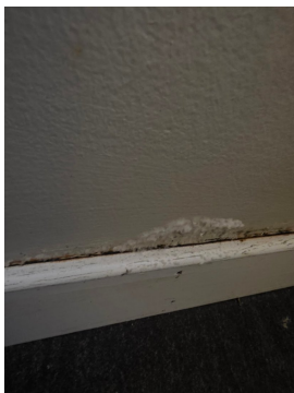
Soppdannelse på overflater og listverk.
