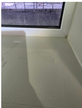
Kondens og stående vann i vinduskarmer
