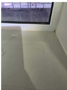
Kondens og stående vann i vinduskarmer
