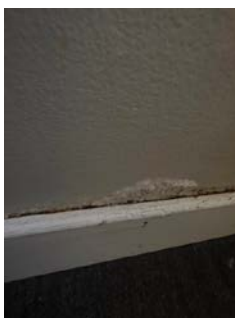
Soppdannelse på overflater og listverk.
