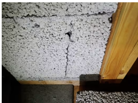
Sprekk i brannmur i gang.
