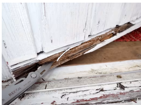
Råte i dørblad.
