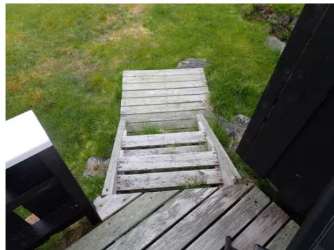
Slitasje i trapp.
