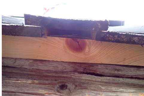
Manglende musetetting mellom kledning og vegg.
