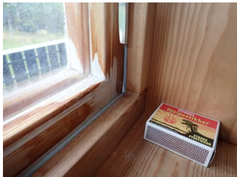
Fuktmerker i karm og utett pakning.
