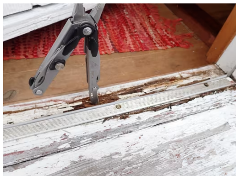
Råte i terskel.
