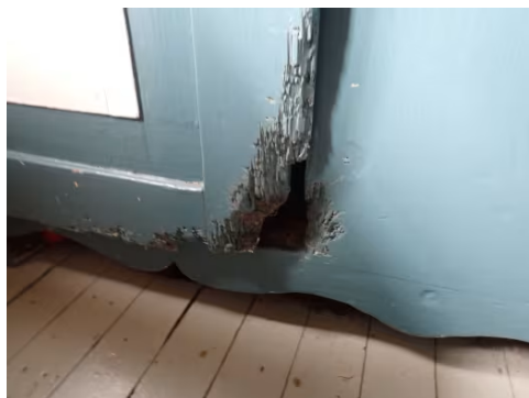
Skader i innredning.
