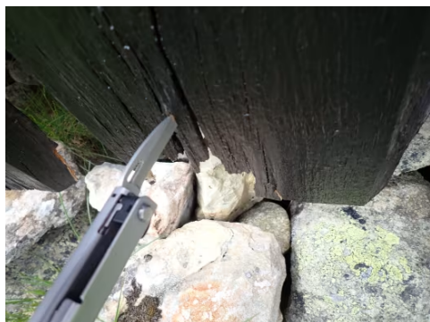
Råte i rekkverksbord.
