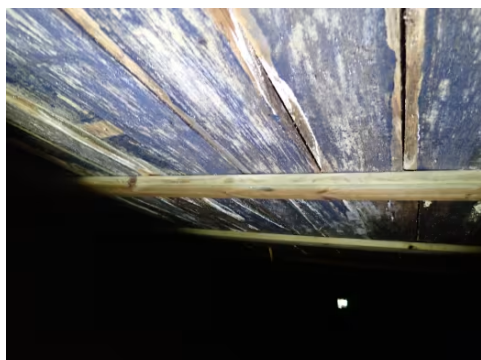
Råte i stubbegulv i kryprom under vindfang.
