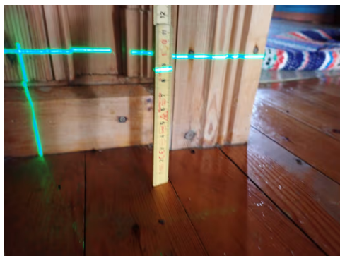
Målinger innvendig viser større skjevheter.
