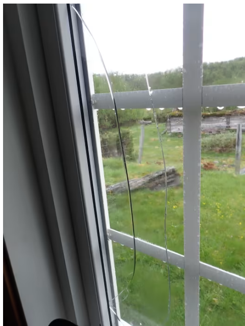
Sprekk i glass i kjøkkenvindu.
