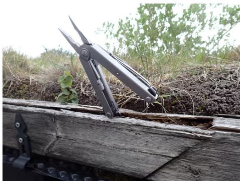
Råte i torvhaldsstokk.
