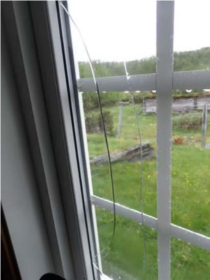
Sprekk i glass i kjøkkenvindu.
