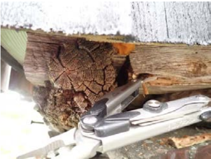
Tydelig råte i tømmeret oppunder kledning ved terrasse.
