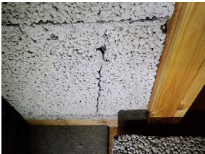
Sprekk i brannmur i gang.
