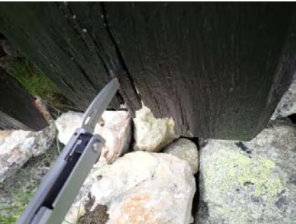
Råte i rekkverksbord.
