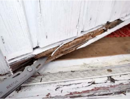
Råte i dørblad.
