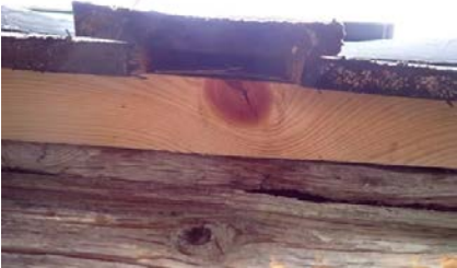
Manglende musetetting mellom kledning og vegg.
