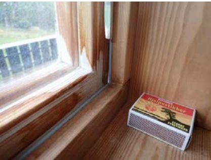
Fuktmerker i karm og utett pakning.
