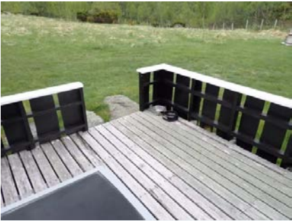
Oversiktsbilde. Man ser tydelig værslitasje i dekket.
