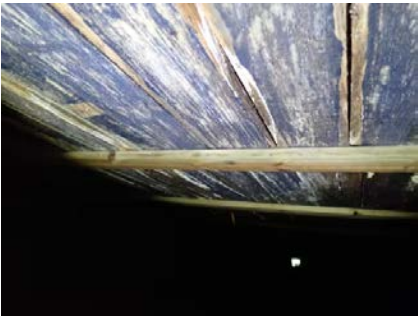
Råte i stubbegulv i kryprom under vindfang.
