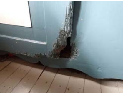
Skader i innredning.
