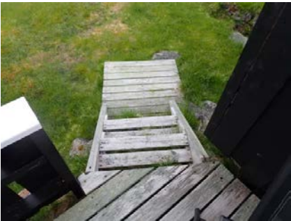
Slitasje i trapp.
