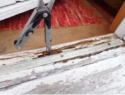
Råte i terskel.
