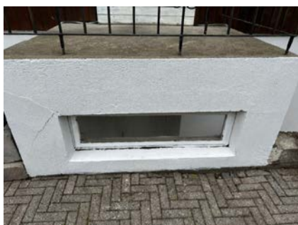
Setninger i trapp.
