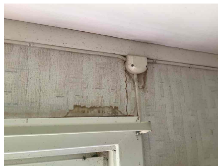
Rennemerker på vegg i 2. etasje.
