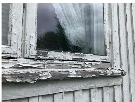
Eksempel på slitasje og tilstand.
