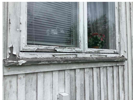
Eksempel på slitasje og tilstand.
