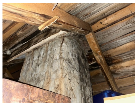
Fuktmerker i treverk rundt pipe.
