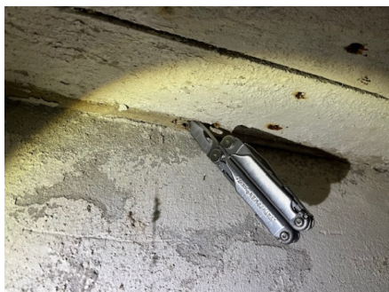
Det er noen steder begynnende råte i panel i himling.
