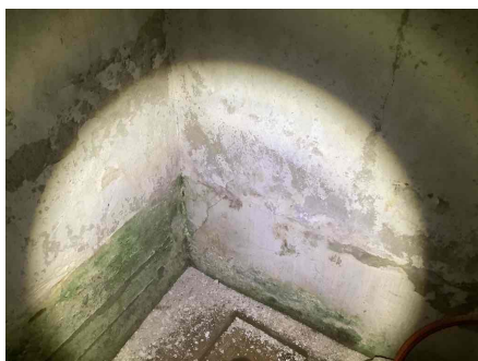
Saltutslag og avskaling på vegger.
