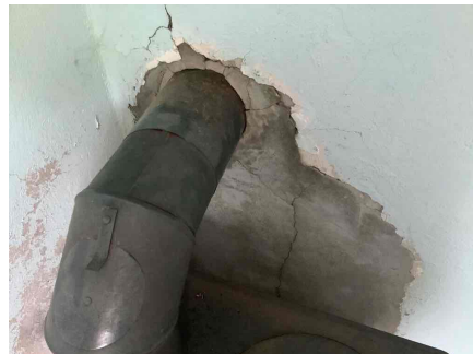
Avskaling rundt røykrør.
