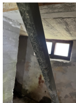
Muggsopp på overflater på trapp til kjeller.
