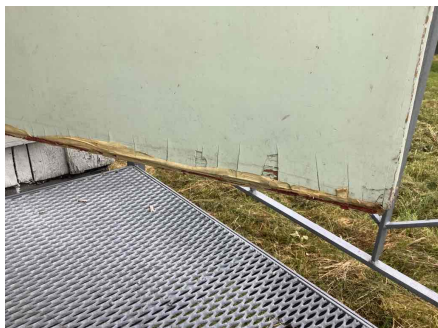
Slitasje på entredør.
