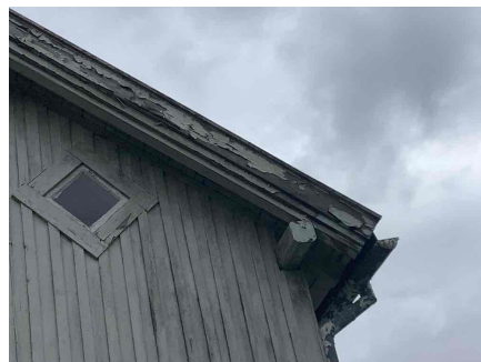
Slitasje på utvendige overflater.
