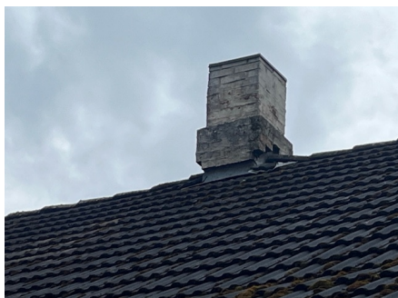
Det gaper i beslag rundt pipe.
