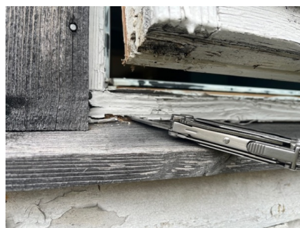
Noen vinduer har begynnende råte
