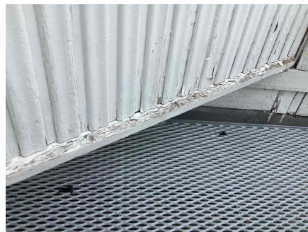
Slitasje på entredør.
