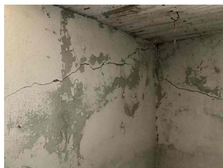
Innvendige sprekker i grunnmur.
