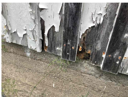
Råteskade i trekledning.
