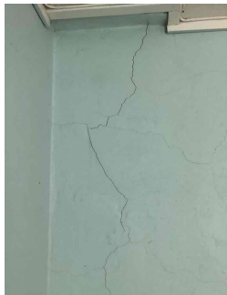
Riss og sprekker i overflate på brannmur.
