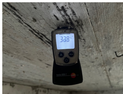
Fukttinnhold i treverk på over 30 vektprosent (fibermetning).
