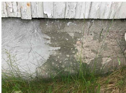
Utvendig sprekk i grunnmur.
