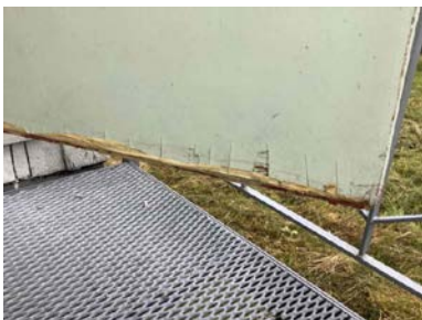
Slitasje på entredør.
