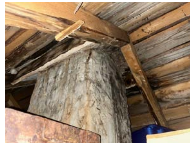
Fuktmerker i treverk rundt pipe.
