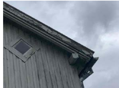
Slitasje på utvendige overflater.
