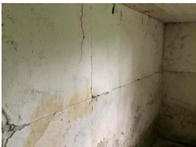
Innvendige sprekker i grunnmur.
