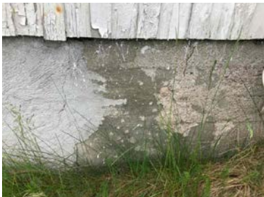
Utvendig sprekk i grunnmur.
