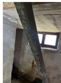
Muggsopp på overflater på trapp til kjeller.
