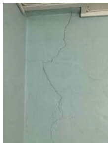
Riss og sprekker i overflate på brannmur.
