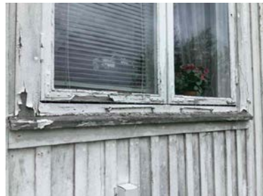
Eksempel på slitasje og tilstand.
