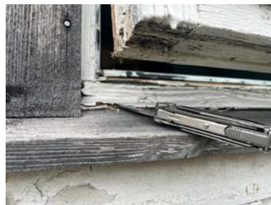
Noen vinduer har begynnende råte
