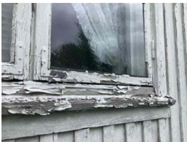
Eksempel på slitasje og tilstand.
