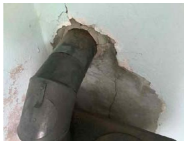
Avskaling rundt røykrør.
