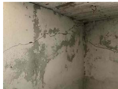
Innvendige sprekker i grunnmur.
