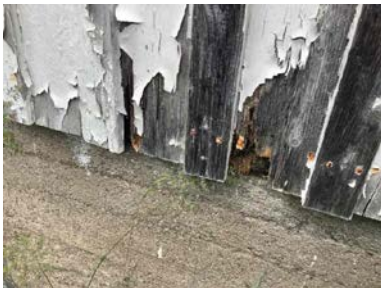
Råteskade i trekledning.
