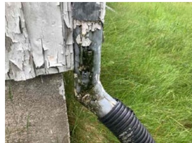
Utetthet på takrennenedløp.
