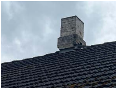
Det gaper i beslag rundt pipe.
