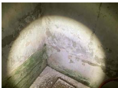
Saltutslag og avskaling på vegger.
