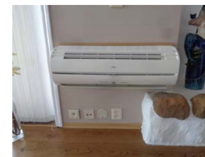
Varmepumpe i stue.
