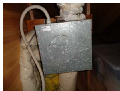
Motor til ventilasjon i knevegg på loft.
