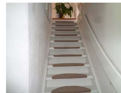
Det mangler håndlister på vegger i trappen.
