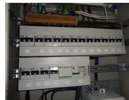
Sikringsskap i trapperom.
