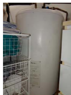
Varmtvannsbereder i vaskerom.
