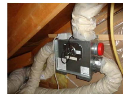
Motor til ventilasjon i knevegg.
