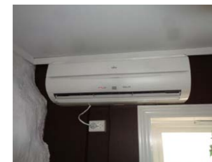
Varmepumpe i peisestue.
