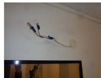
Løs ledning på et bad.
