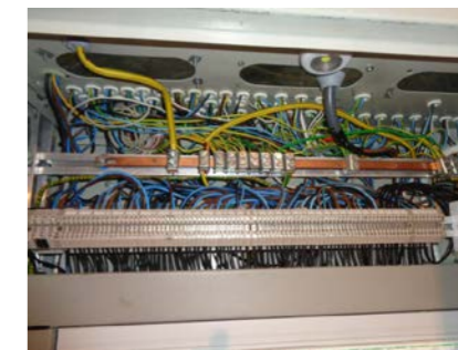
Noe dårlig inndekking i skapet.
