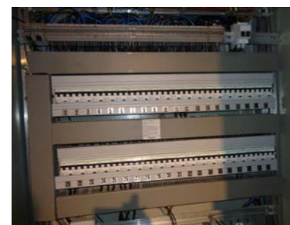
Sikringsskap i bod.
