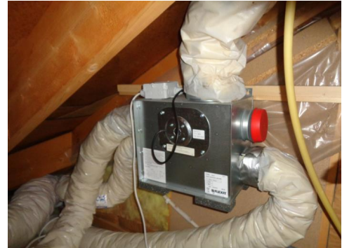
Motor til ventilasjon i knevegg.
