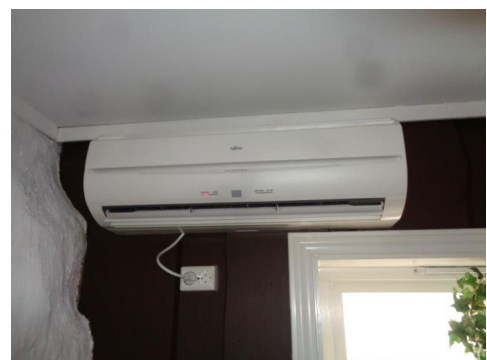
Varmepumpe i peisestue.
