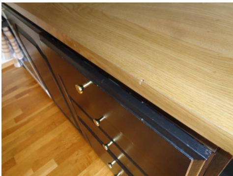
Skader på benkeplater.
