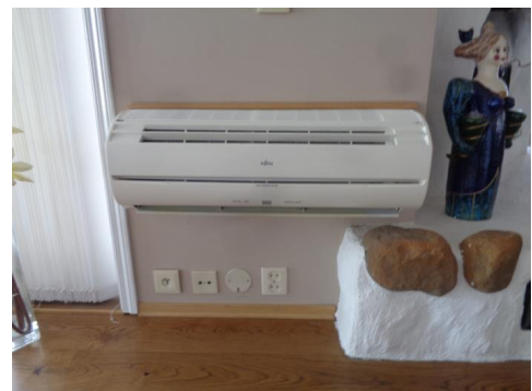
Varmepumpe i stue.
