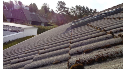
Noe mose på yttertak.
