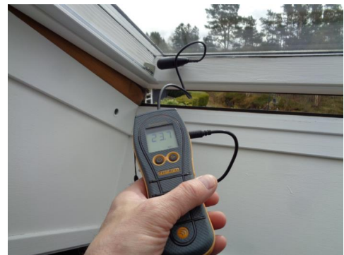
Det ble målt fuktverdier i trekarmer til veluxvinduer.
