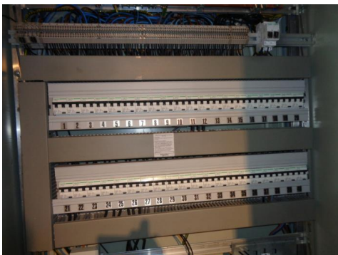
Sikringskap i bod.
