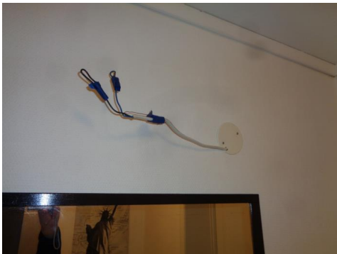
Løs ledning på et bad.
