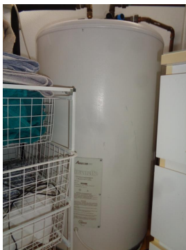
Varmtvannsbereder i vaskerom.
