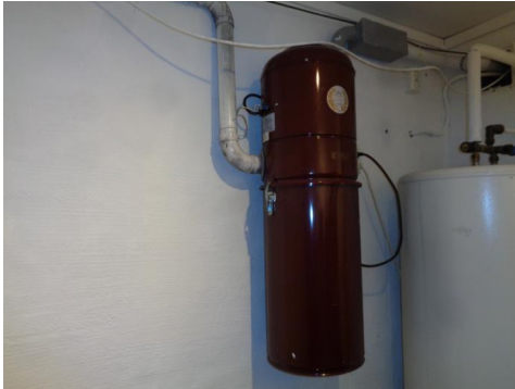
Sentralstøvsuger i bod.
