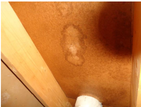
Noe fuktmerker på sutakplater.
