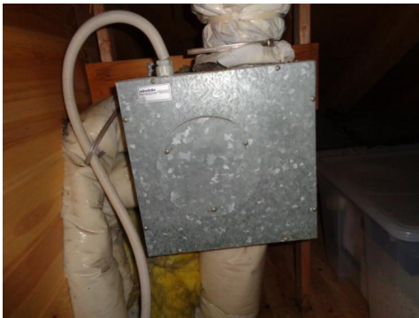
Motor til ventilasjon i knevegg på loft.
