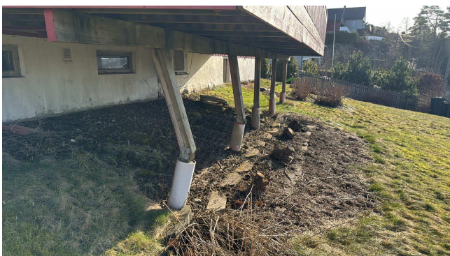
Bildet viser støttepilarer som ikke sitter tilstrekkelig i fundamentet.
