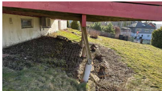
Bildet viser støttepilarene som ikke sitter tilstrekkelig i fundamentet.
