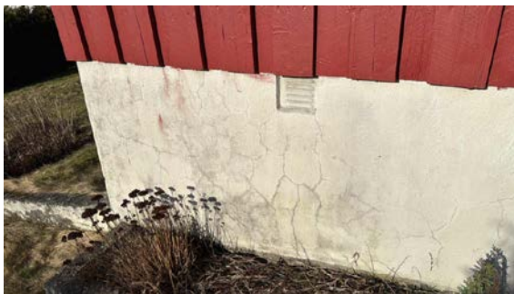
Bilde av sprekker i grunnmuren.
