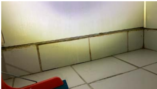
Baderomsplater er ikke montert i henhold til leverandørens anvisning. Silikonfuge mellom bunnlist og baderomsplater har utettheter- eller mangler.
