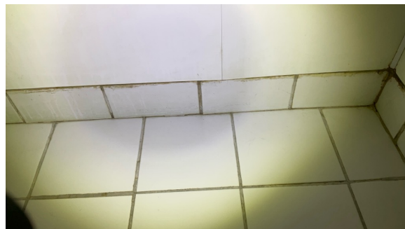
Det er registrert skade/svelling på overflate.
