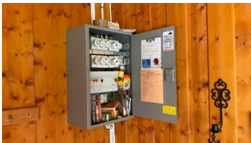
El-anlegg med skru- og automatsikringer. I hovedsak åpent ledningsnett. Sikringsskapet er plassert i soverom.
